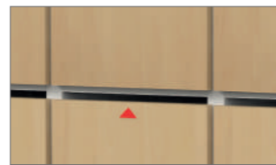
■ ANTA FESSURA PER DOCUMENTI
